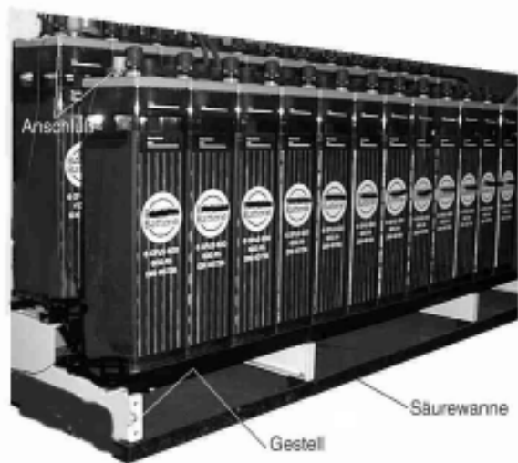
Bild 8-3: Batterieanlage 48V mit Gestell und Säurewanne
